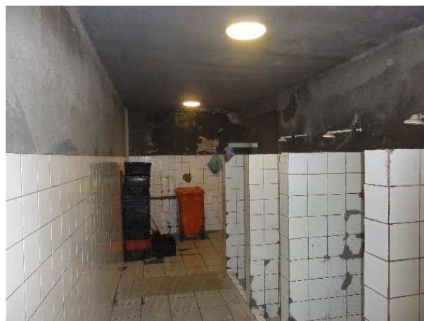
Figura 3 banheiro da cela C
