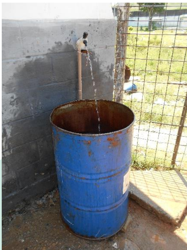
Figura 1 ponto de captação de água
